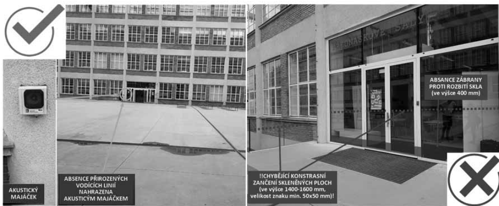
Obr. 2 – Příklad osazení akustického majáčku na vstupu do budovy, který splňuje funkci vodicích linií (vlevo) a příklad chybného technického a kontrastního řešení tohoto vstupu (vpravo)
