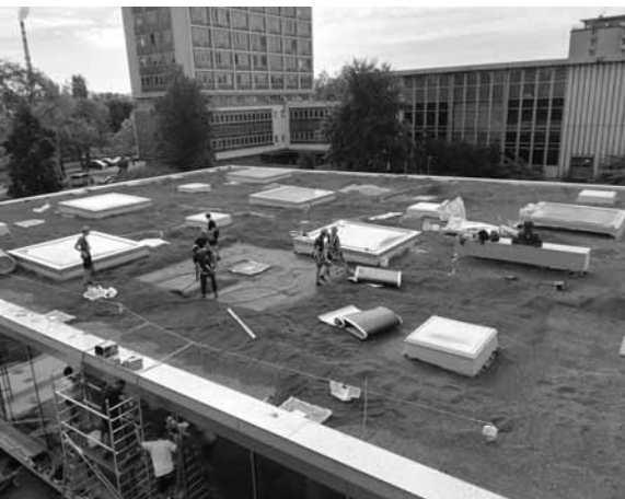
Momentka z doby výstavby: střešní světlíky a první vrstva podkladu pro „zelenou střechu“, která vytvoří příjemné klima
