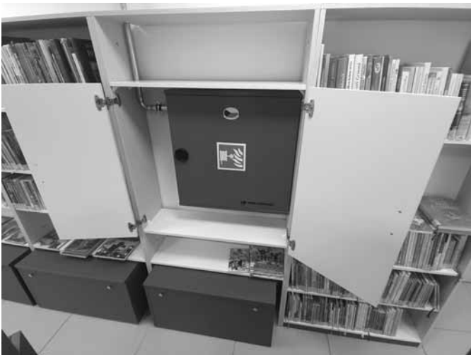
Nevhodně umístěný hydrant, dodaný až v průběhu montáže nábytku bez předchozí dokumentace...
